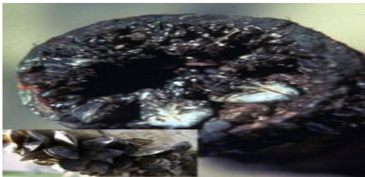
Рисунок 1. Трубопровод на грани блокирования
