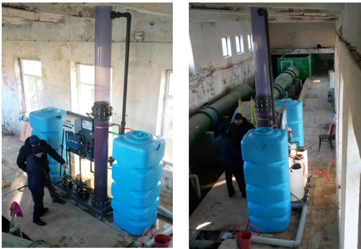
Рисунок 2. Пилотная установка после монтажа на объекте исследования – в здании смесителей (г. Баку)
