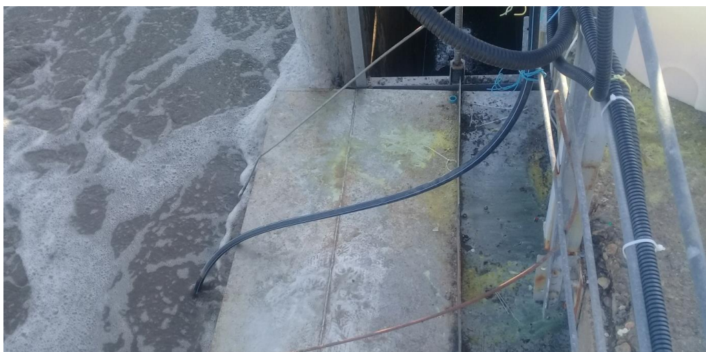
Фото 5. Ввод коагулянта перед коробом перетока стока из аэротенка во вторичный отстойник
